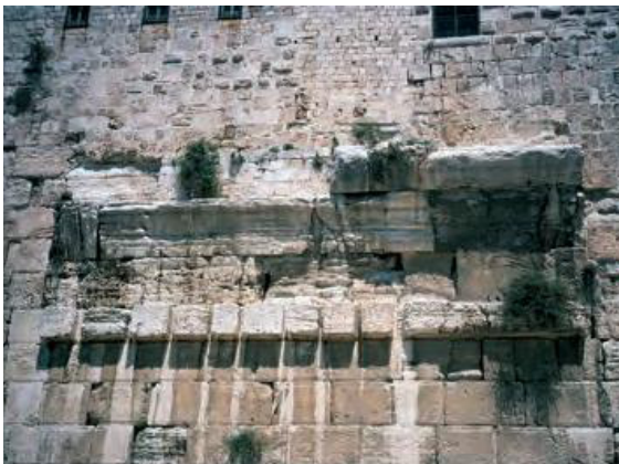
Abb. 4 Der nach Robinson benannte Mauervorsprung bei der Südwest-Ecke des Tempelbezirks in Frontalansicht
